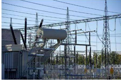
Suomen kantaverkko on miltoitettu niin, että se kestää Olkiluodon ongelmat, jos ydinvoimalan kolmosreaktorin tulee vika ja se putoaa pois sähköverkosta. Kuvassa on Olkiluodosta kantaverkkoon lähtevä linja. KUVA: RONI LEHTI / LEHTIKUVA
